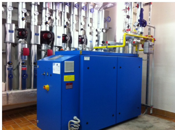
BHKW – Rathaus Ellwangen
