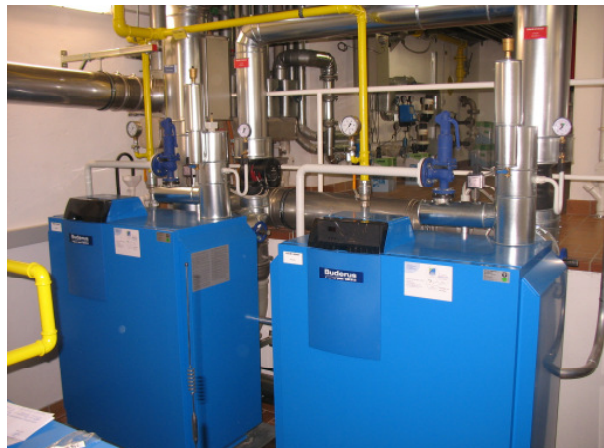
Heizkessel – Rathaus Ellwangen
